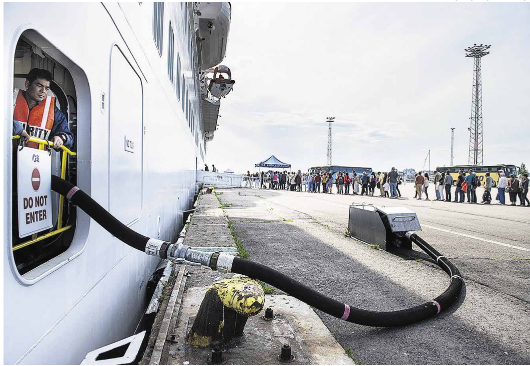
Länsisatamassa laivojen jätevedet tyhjennetään letkuilla putkiston kautta kaupungin viemäriverkkoon. Suljetussa painevesijärjestelmässä ei ole ilma-aukkoja, joten hajua ei pääse karkaamaan. Kuvassa on Princess Cruisesin Regal Princess Jätkäsaaren Melkinlaiturissa kesällä 2015.
