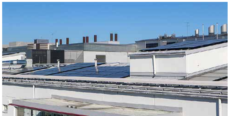
Taloyhtiö Rusokkikujaan kuuluu kaksi kerrostaloa joissa on 146 asuntoa. Paneeleita on katoilla yhteensä 215 kappaletta, eli ”niin paljon kuin mahtuu”.
