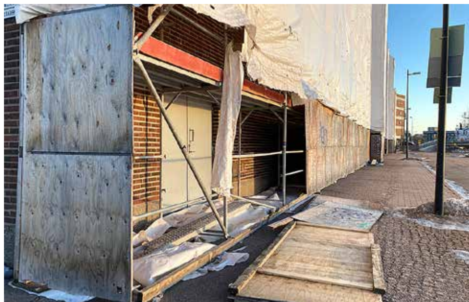
Tuulisuus tulee ottaa meren rannalla huomioon jo rakentamisvaiheessa. Alkuvuonna valmistuneessa Oikeustalon remontissa Salmisaarella tuuli pääsi irrottamaan julkisivun pressuja ja vanerilevyjä.
