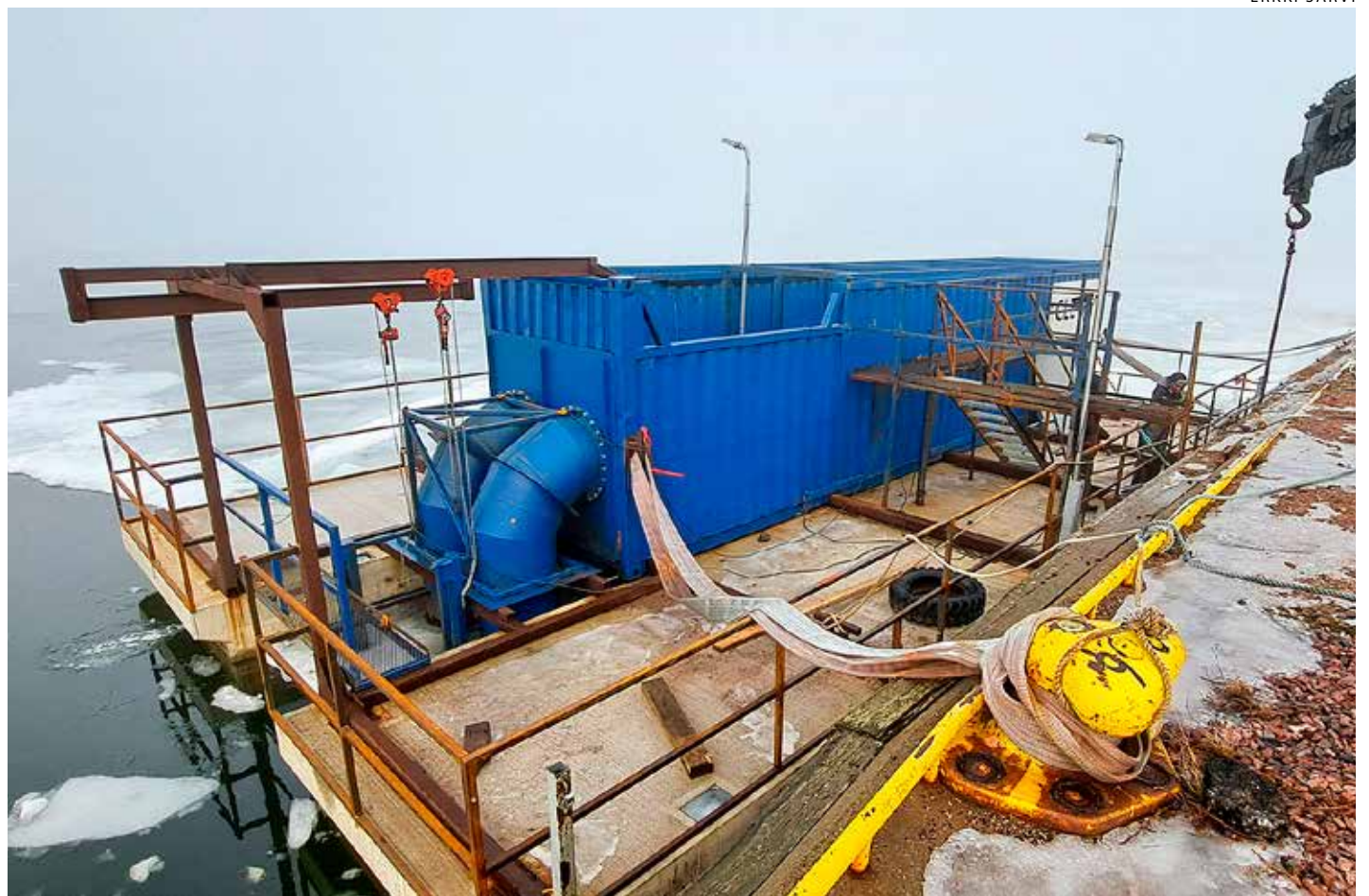
Clewatin lumensulatusyksikkö on ollut käytössä Jätkäsaaren Saukonlaiturissa maaliskuusta 2022. Uusi paikallinen lumensulattamo Lumipower tulee testikäyttöön lähiaikoina kuivalle maalle korttelin päähän Saukonlaiturista.
